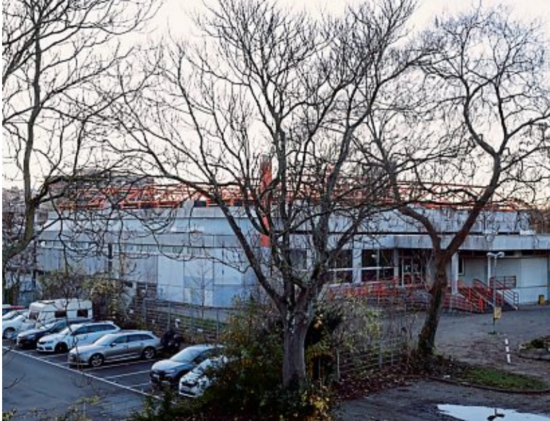
Das Dach der Sporthalle ist undicht, und der Sportbetrieb wurde bis mindestens Ende Januar 2026 eingestellt.
